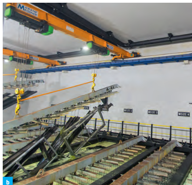
b Blick in die Vorbehandlungshalle mit zahlreichen Tauchbecken.
