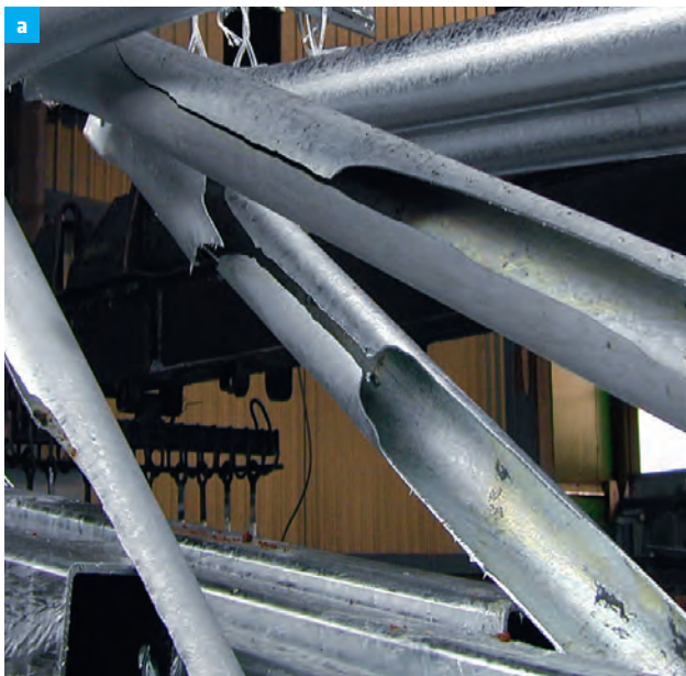
a Gerissene Rohrprofile aus Feinkornbaustahl
