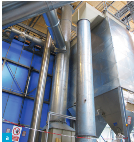
a Abluftkanäle und Filteranlage.
