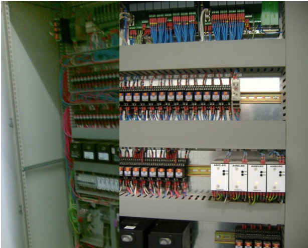
Schaltschrank der Ofensteuerung
